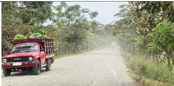
Vía de comunicación entre recintos, con alto deterioro
