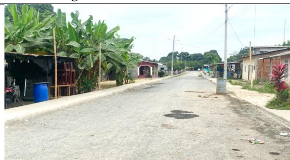
Estado de vía de comunicación interna, recinto Las Ramas
