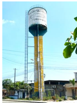
Tanque elevado, agua potable
